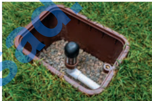
Nainštalovaný vzduchový/vákuový poistný ventil
